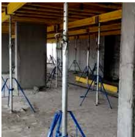
Рисунок 2 - Загальний вигляд горизонтальної опалубки для бетонування монолітного перекриття на телескопічних тріногах Джерело розроблене авторами
